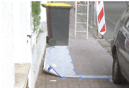
Abb. 5: Unzureichend verklebte Ränder
