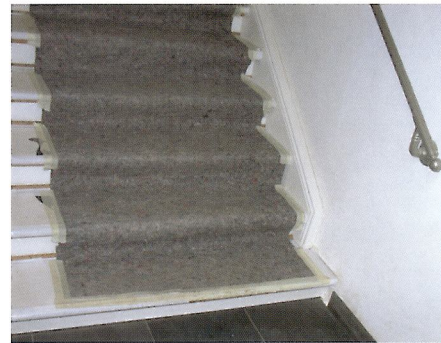
Abb. 6: Malerabdeckvlies unzureichend mit Klebestreifen auf einer Treppe befestigt
