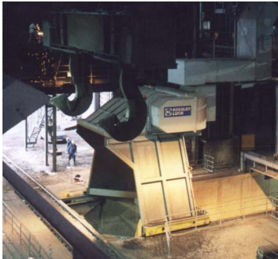
Abbildung 3: Erfassungseinrichtung an der Roheisenumfüllgrube [3]
