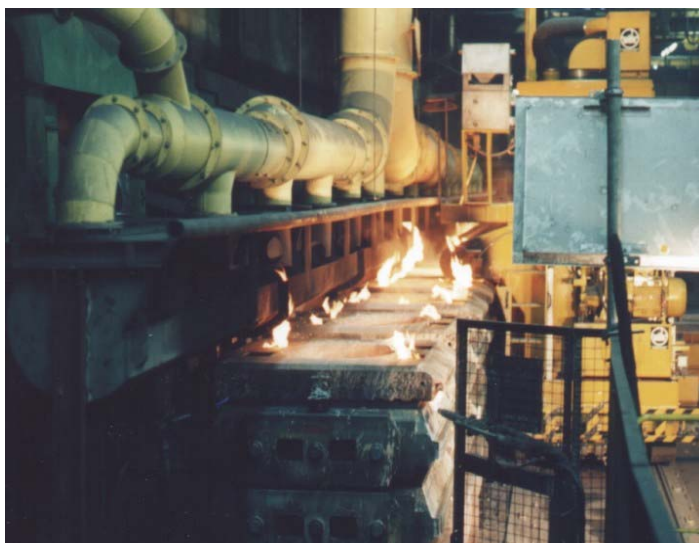
Abbildung 12: Beispiel für den Einsatz einer Wirbelhaube an einer Gieß- und Kühlstrecke
