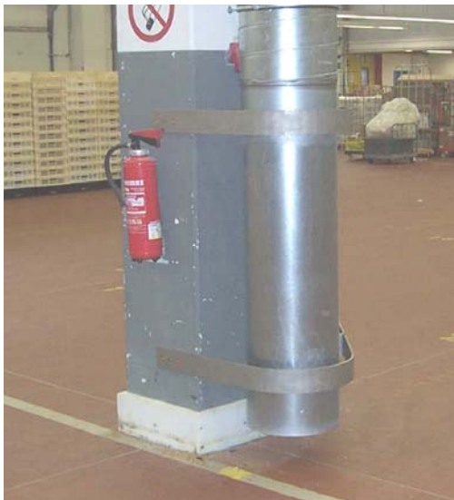
Abbildung 8: Beispiel für einen über dem Fußboden positionierten Quellluftdurchlass mit Anfahrerschutz
