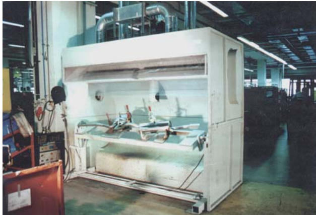
Abbildung 10: Beispiel für eine Schweißkabine mit integrierter Luftzufuhr und Halte- konstruktion für das Werkstück
